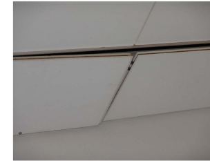
Lose Deckenplatten nach dem Einziehen von EDV Kabel
