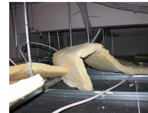
Verschobene Dämmplatten. Schall- und Dämmprobleme sind die Folge.
