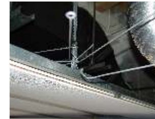
Nachträglich veränderte Deckensysteme, Absturz der Decke drohte.
