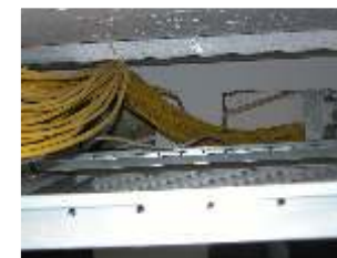
Beschädigter Brandschutzschott nachdem Kabel nachgerüstet wurden.
